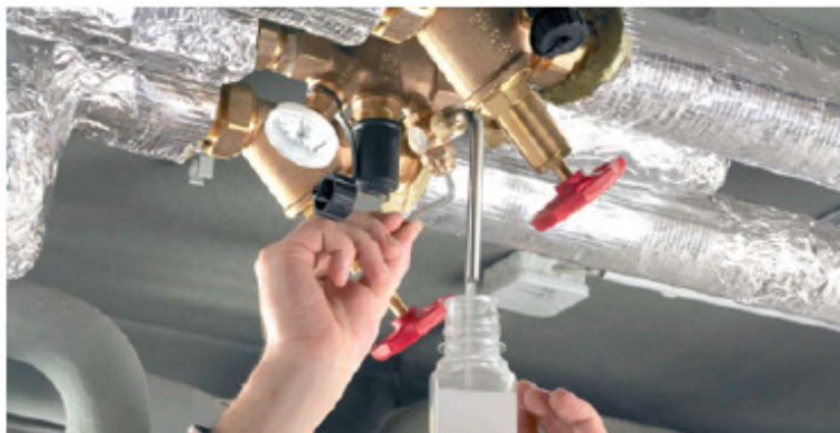
Wasserprobenentnahme an einem Kemperventil. Foto Kemper
