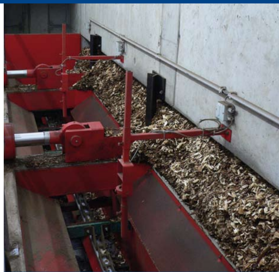
Die Holzhackschnitzel gelangen über ein Förderband zur Wärmeerzeugungsanlage. Der neue Kessel hat eine Leistung von 1,3 MW.
